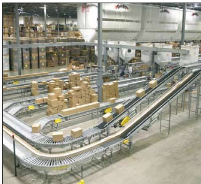
Автоматизированное складское оборудование
