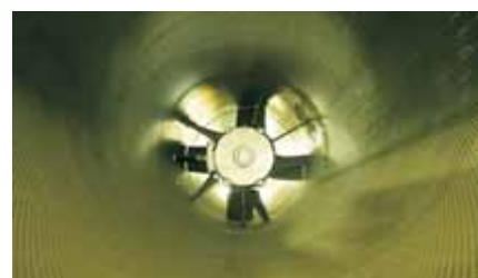
Система вытяжки воздуха 110 кВт
